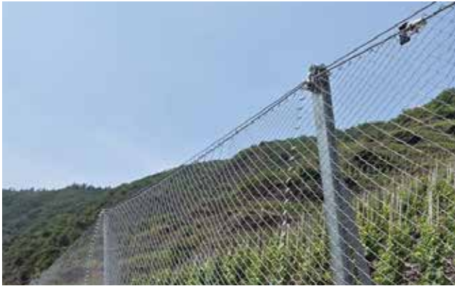
Abb. 10: Geobrugg GUARD zur Fernüberwachung am Steinschlagschutzzaun, oben rechts
