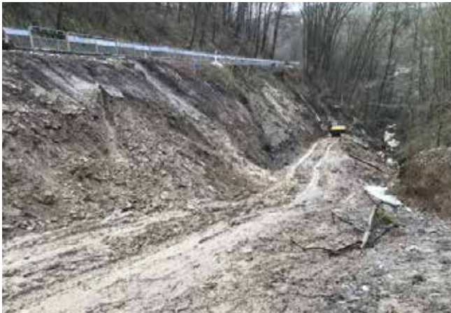
Abb. 2: Zustand Sanierungsabschnitt nach der Sturzflut. Quelle: Eigene Aufnahme.
